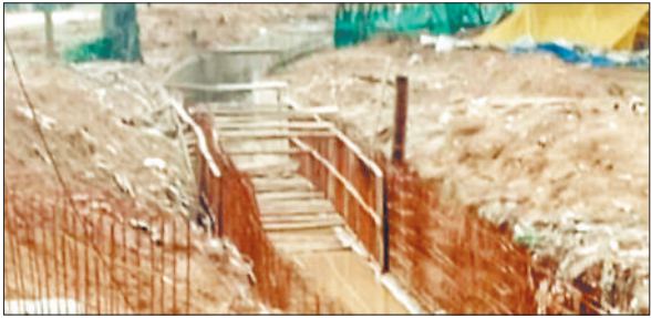
अधूरा नाली निर्माण ।
